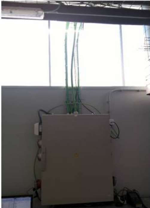
Imagen 7: Cuadro de energía
