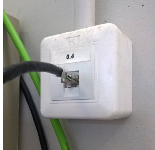
Imagen 4: Caja de conexión
