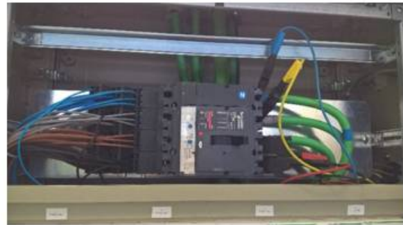
Imagen 8: Disyuntor o interruptor general
