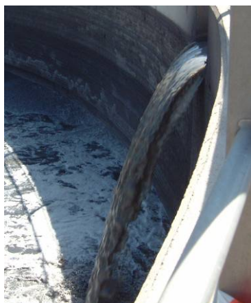
Figura 1. Detalle de descarga en balsa de homogenización.
